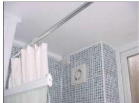
Bathroom extract fan
